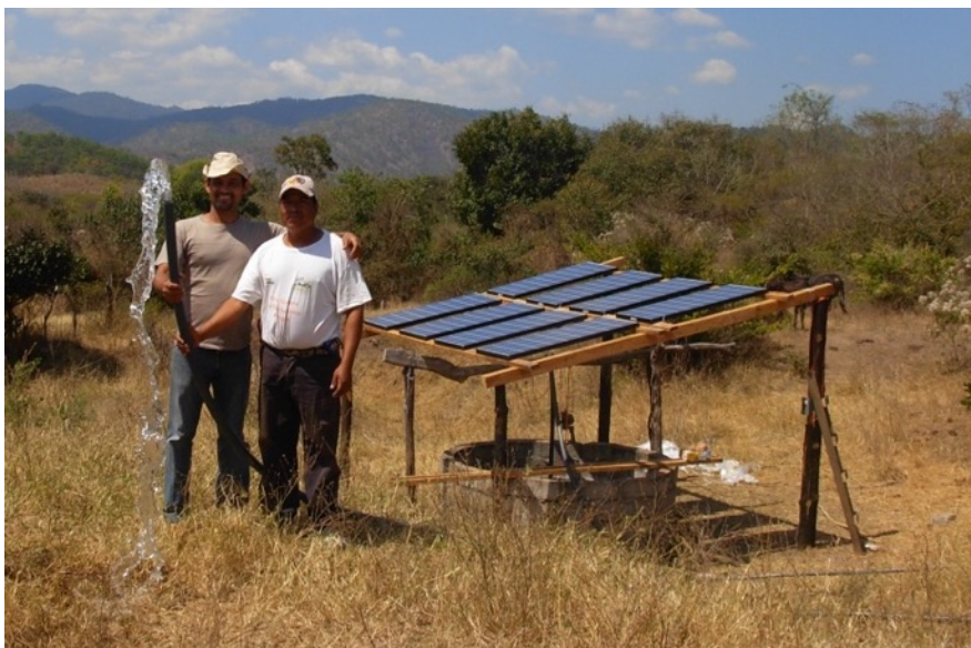
Figura 25. Sistema de Bombeo Fotovoltaico de 1080 W, con una bomba automática de corriente directa. Foto: N. Farrera-Vázquez.
