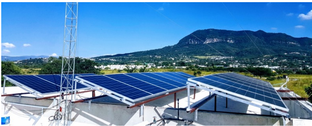
Figura 27. Sistema Fotovoltaico Interconectado a la Red de CFE de 5 KW con Microinversores. Foto: N. Farrera-Vázquez.
