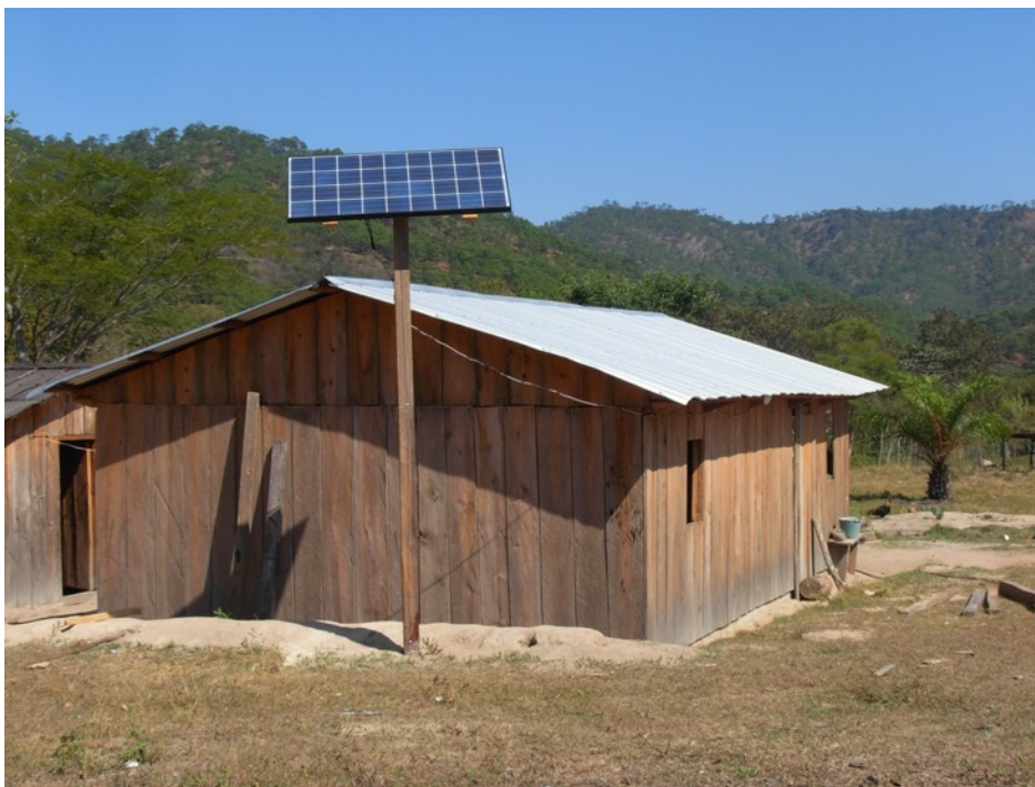
Figura 26. Sistema Fotovoltaico Autónomo individual de 135 W implementado en Monte Horeb, Cintalapa, Chiapas. Foto: J. Moreira-Acosta.
