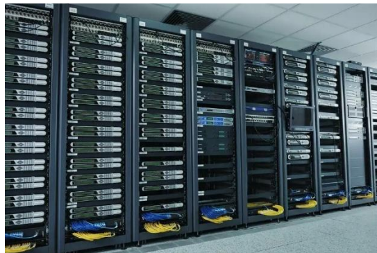
Figura 23. Centro de datos y equipos conectados
