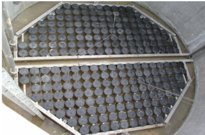
Figura 32. Difusores instalados en los desarenadores de flujo inducido. Fuente: http://www.slideshare.net
