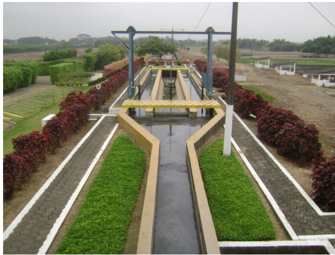
Figura 29. Desarenador de la Planta de Tratamiento de aguas residuales. .Fuente: EMSABA EP
