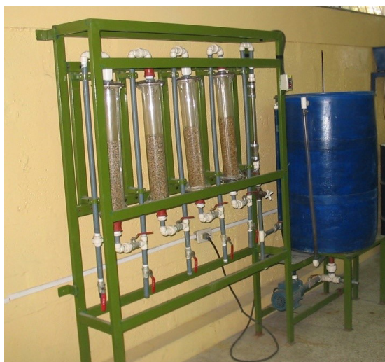
Figura 37. Columnas de Neutralización con lecho de caliza Flujo ascendente. Fuente: Elaboración propia.
