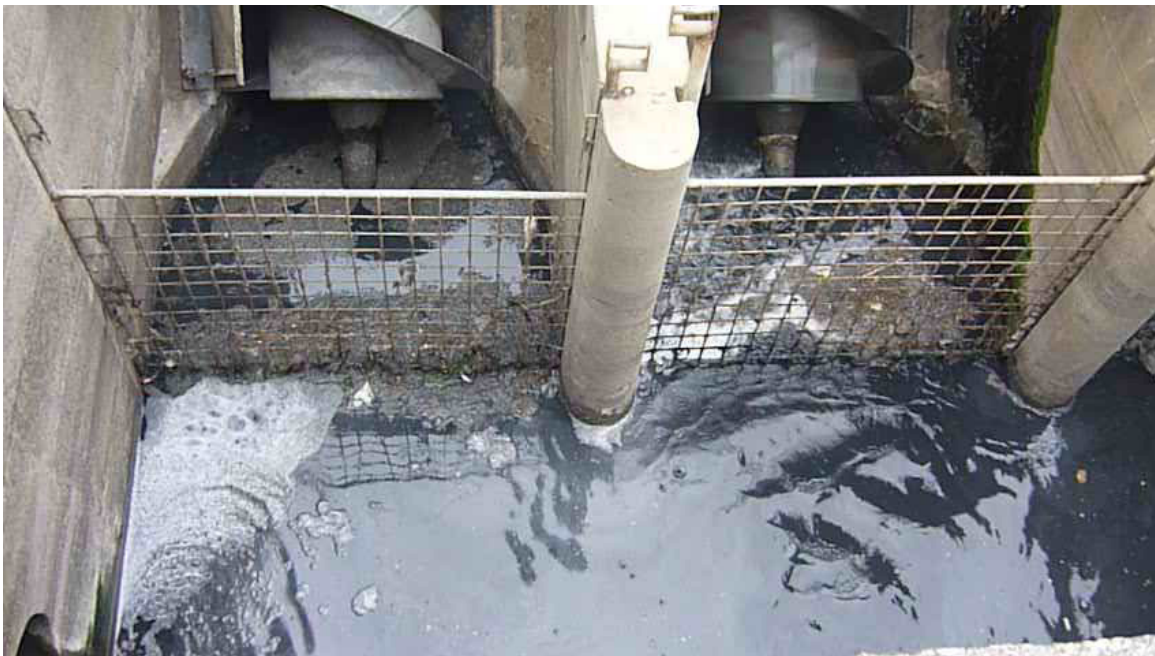
Figura 24. Pozo de gruesos Fuente: Visita industrial FIQ
