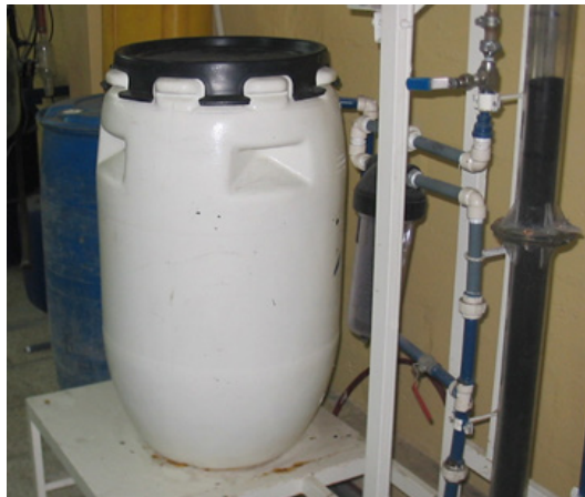
Figura 22. Tanque de almacenamiento Fuente: Autoría propia.
