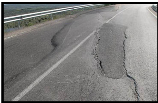
Ilustración 10: Ahuellamiento en la superficie del concreto asfáltico
