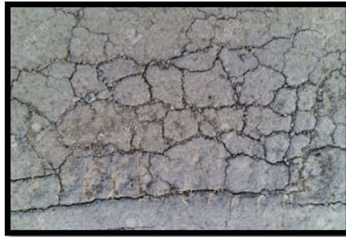
Ilustración 9: Agrietamiento por fatiga en el concreto asfáltico
